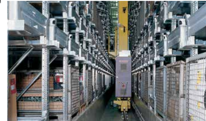
Automatizovaný paletový regál „jednomístného úložného systému“
