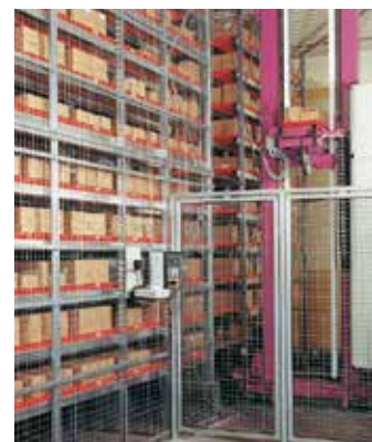
Ochranná mříž a krytování
